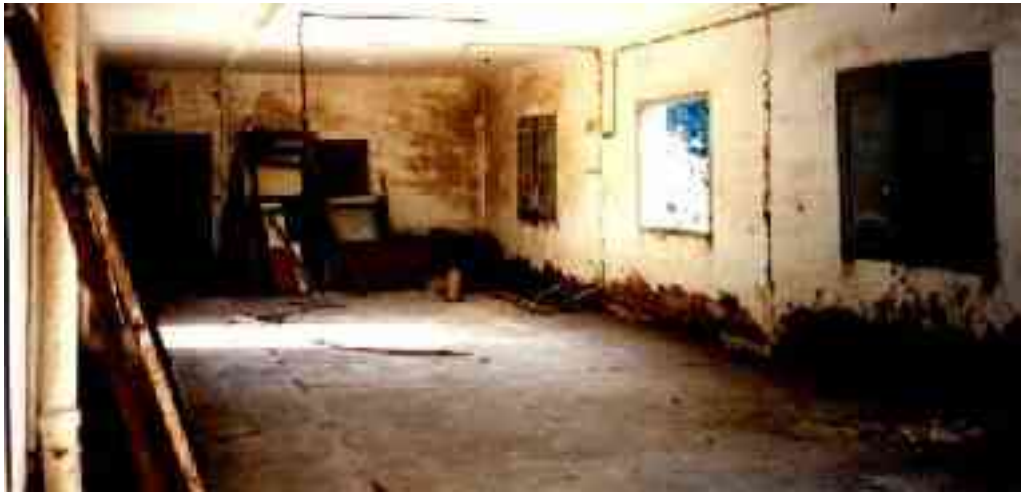
Fig. 4 – Estado – después de derribo de tabiquería – en que se encontraba la planta baja del edificio “A”. Se destaca a la derecha de la imagen (antiguas habitaciones) la humedad y el desconchado de su yeso original hasta la altura de las ventanas. En la planta baja el muro norte queda enterrado por los aluviones de tierra procedentes de bancales superiores destruidos.
