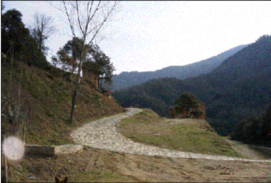
Fig.31 – Panorama del 2000 después del movimiento de tierras en los accesos al edificio B y la canalización de las aguas pluviales hacia el río realizadas con la Subvención 0,5% IRPF del MTAS 1998 y el primer Taller de Empleo subvencionado por el Departament de Treball y el FSE.
