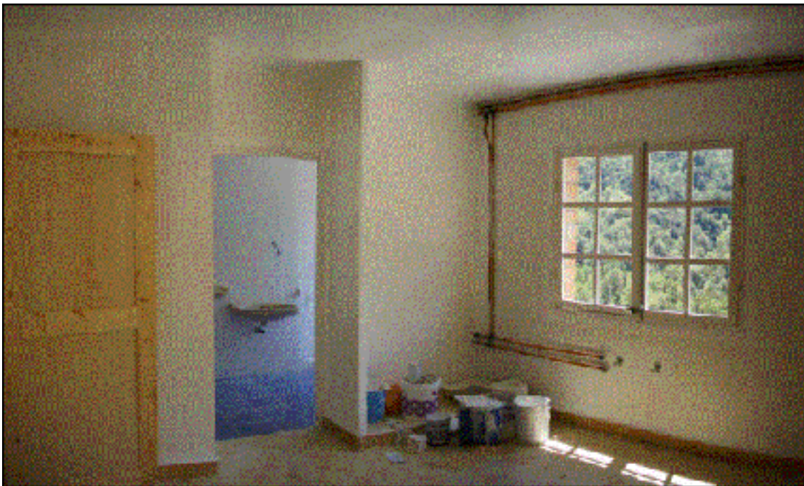
Fig. 36 – (abajo) Habitación de primera planta con tendido de calefacción y baño terminado, antes de pintura y colocación de mobiliario.
