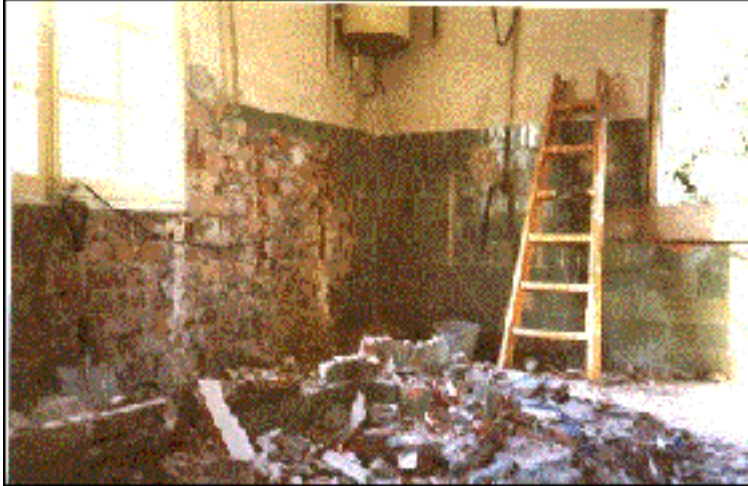
Fig.21 – Reconstrucción de los baños de la planta cuarta en fase de derribo(1998)
